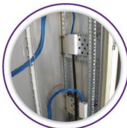
> Arrimages de câbles
